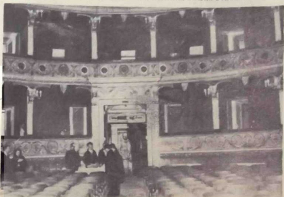
Com'era il teatro prima dell'inizio dei lavori. Le sue condizioni statiche all'epoca della foto erano già carenti; si vedono, infatti, i componenti di una commissione mentre eseguono gli accertamenti.
